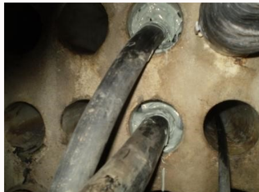
Cables ORANGE polymerisation
